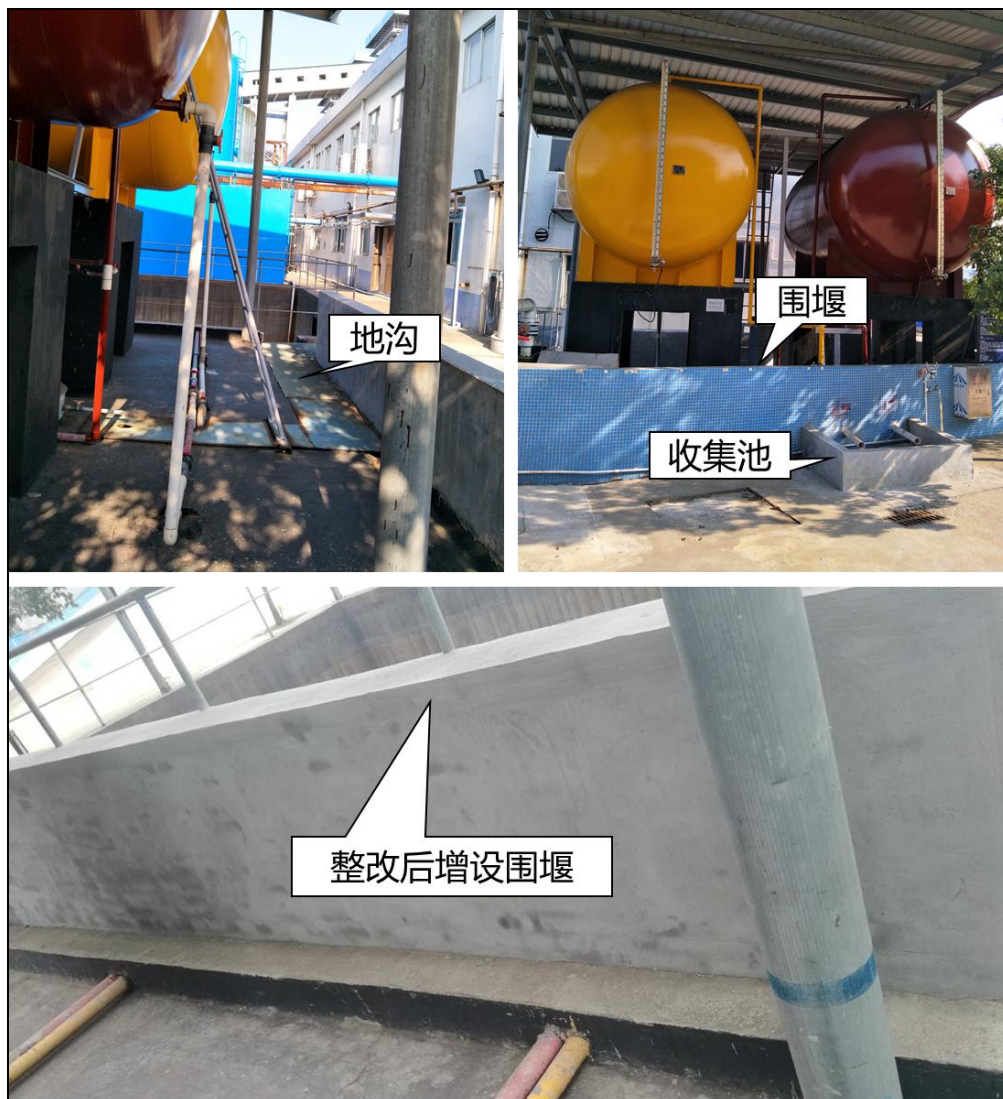
图 5-2 酸碱储罐现场情况
