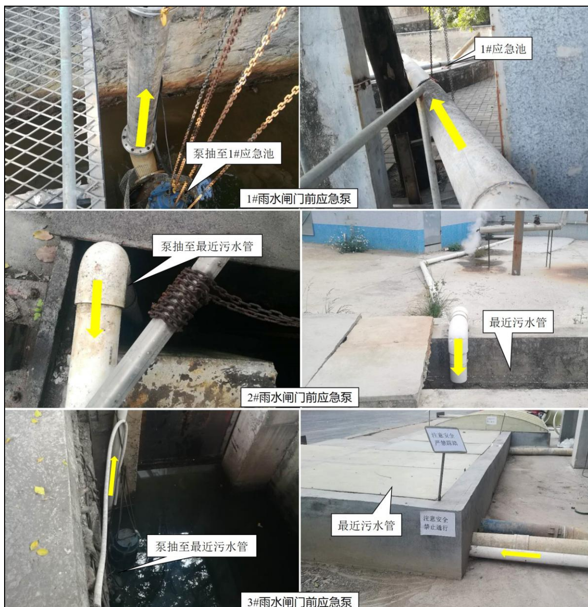
图 6-4 雨水闸门前应急泵及管道情况
